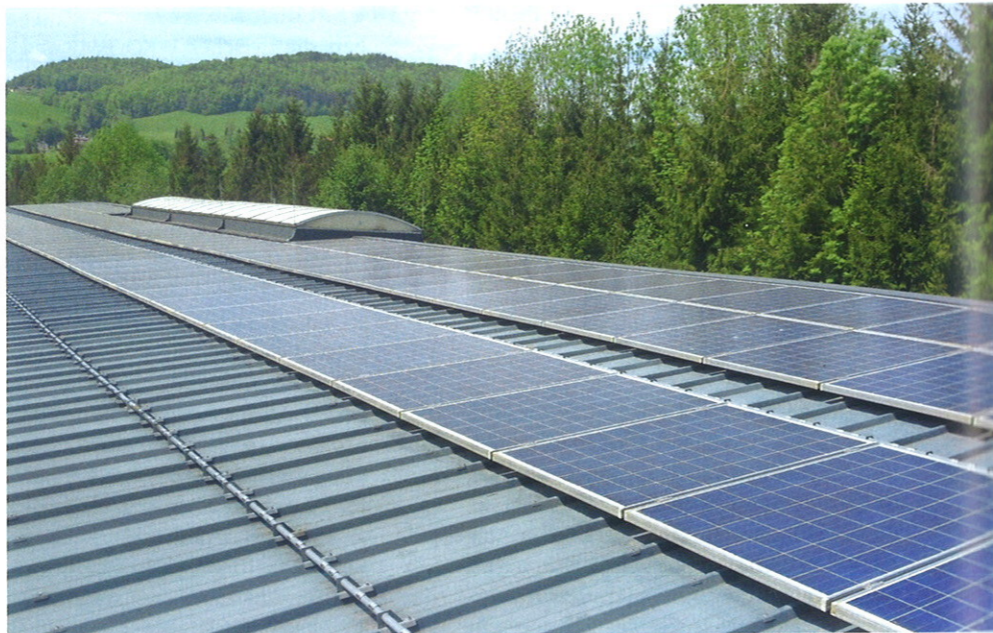
Die 30 kW-Photovoltaik-Anlage soll sich schon in sieben bis acht Jahren amortisiert haben.
